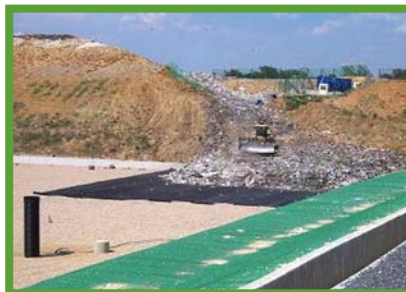
Le centre d'enfouissement de classe 2 implanté à Soignolles-en-Brie
